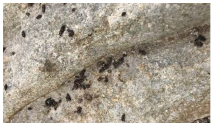
Guano de chiroptères sous l'ouvrage franchissant l'Ouvèze
